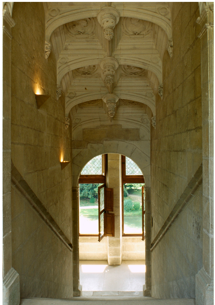
Quatrième volée de l'escalier du château avant restauration © Philippe Berthé
